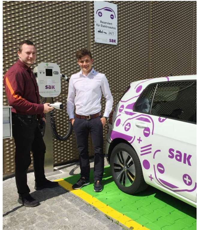
Freuen sich über die neu installierte Ladestation: Carl Herzog, Filialleiter Migros Bischofszell und Jan Müller, Projektleiter Elektroinstallationen der SAK.
