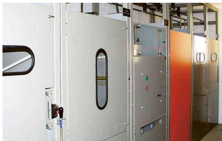
Konventionelle, luftisolierte Anlage
